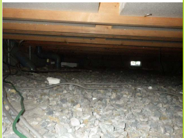
写真2. 床下状況 居住部
